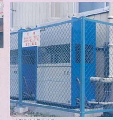
▲大型予冷库用冷凍機
